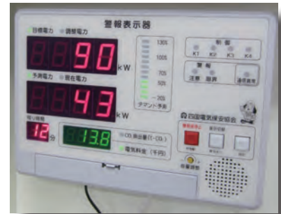
デマンド監視システム
