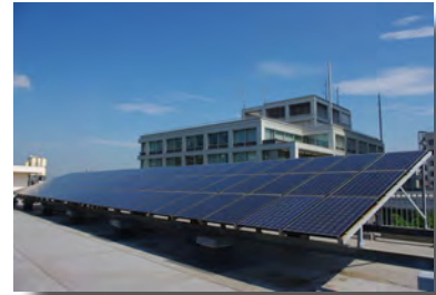
太陽光発電設備
