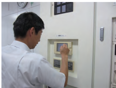
空調機の遠隔操作の様子
